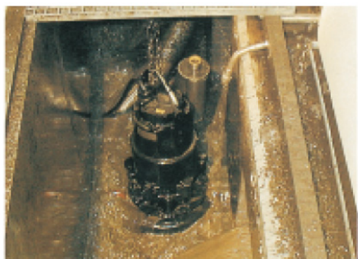
安装在山特维克钢厂冷却油坑的飞力HS 5100耐磨泥浆泵
